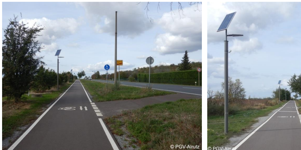
Abb. 7-6: Die Pilotstrecke für intelligente Beleuchtung ist Teil des kreisweiten Radverkehrsnetzes
